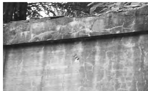
当時の工場壁に残る機銃掃射の弾痕
